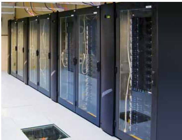
Große Organisation mit großen Einsparpotenzialen: Die Bundesagentur für Arbeit erzielt mit einem neuen Kühlkonzept Einsparungen in Millionenhöhe.
