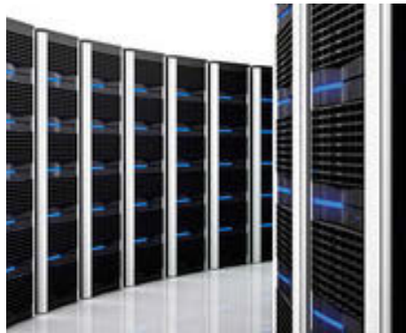
Abb. 8: Energiebewusster Rechenzentrumsbetrieb nach RAL-UZ 161
