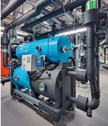
Abb. 25: Neue Absorptionskälteanlage „Prototyp AKA 50 01/2011“
