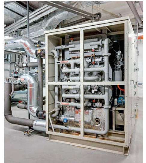
Abb. 24: Ursprüngliche Adsorptionskälteanlage im UBA
