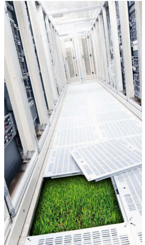
Abb. 19: Grünes Rechenzentrum durch Kaltgang-Einhausung
