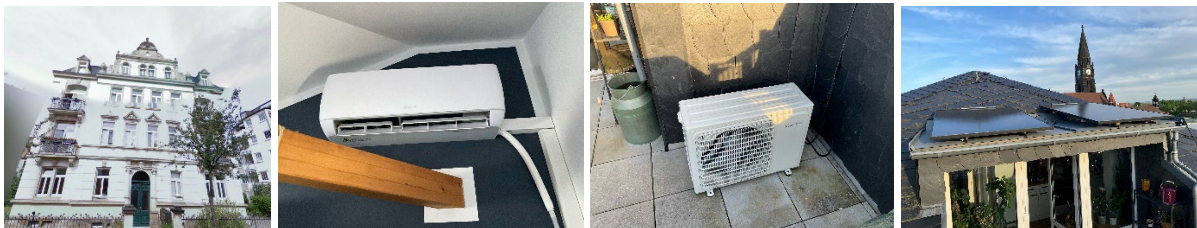
Abbildung 26: Luft-Luft Wärmepumpe in einer Etagenwohnung
