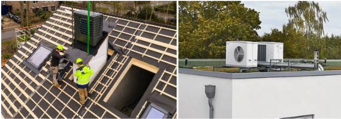
Abbildung 9: Dachplatzierung einer Wärmepumpe
